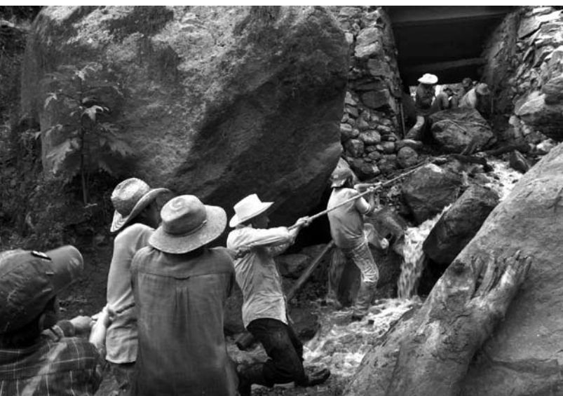
Der Felsbrocken muss weg. Beim nächsten Unwetter könnte sich das Wasser aufstauen und die Brücke wegreißen.
