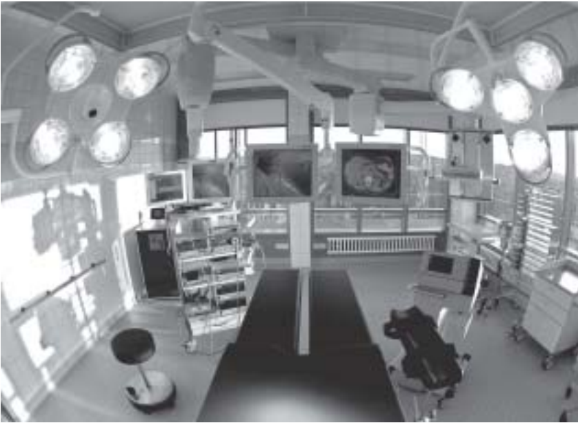
Mehrere Monitore in Blick- und Griffweite des Operateurs. Foto: Archiv
