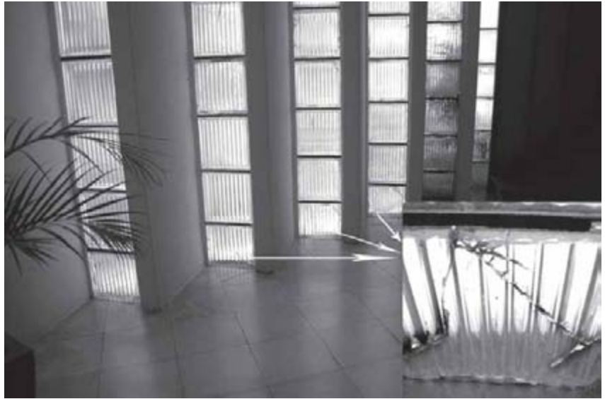
Der Zahn der Zeit nagt an den Glasbausteinen im Altarraum ...
